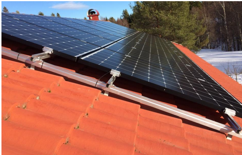
Figur 15 Solpaneler monterade på tegeltak.
