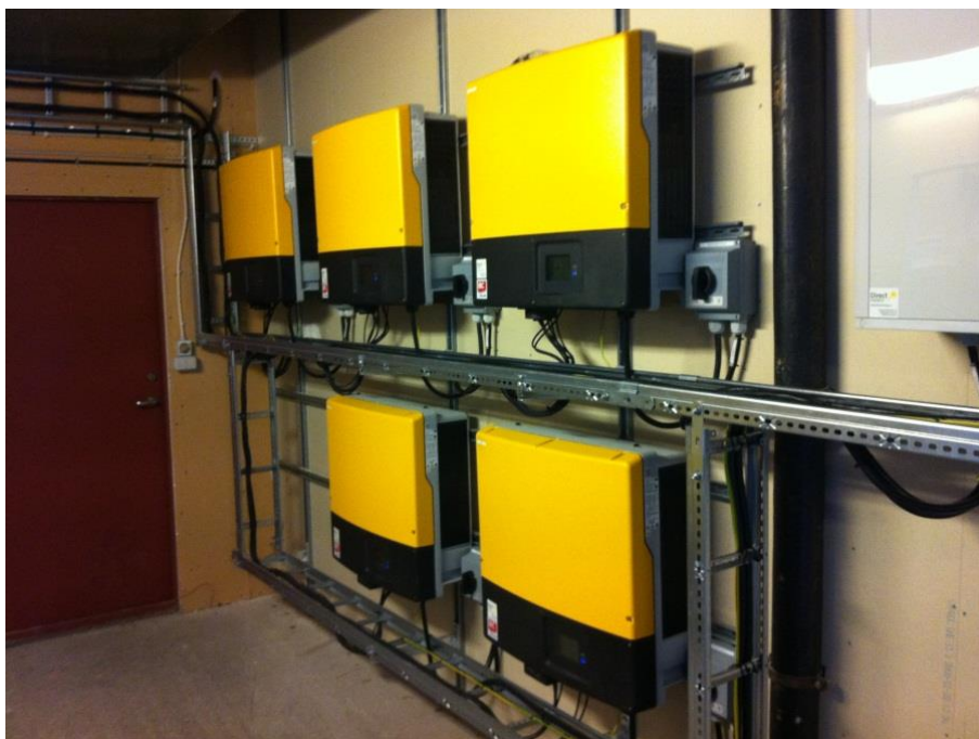
Figur 18 Exempel på installation med växeloriktare från SMA.
